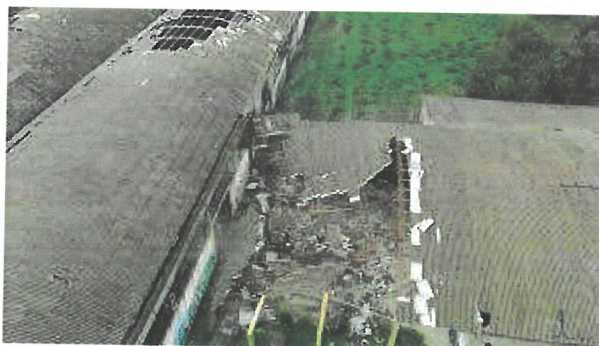
Foto 2 – Dettaglio del crollo della copertura
