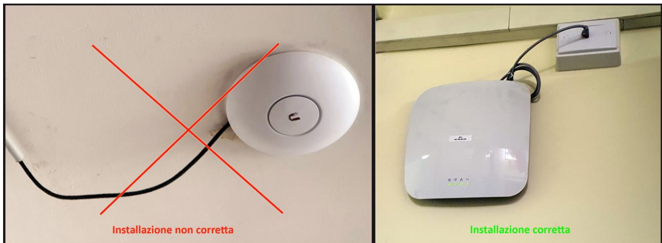
Figura 10 – Installazione corretta dell'Access Point
