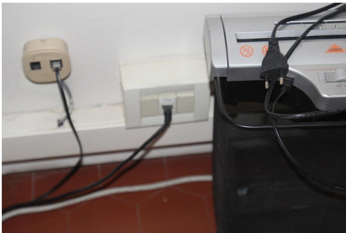
Figura 1 – FO – Particolare cablaggio esistente segreteria
